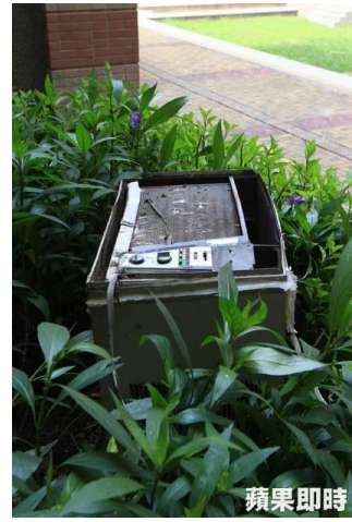
冷氣機從3樓教室跌落1樓地面
