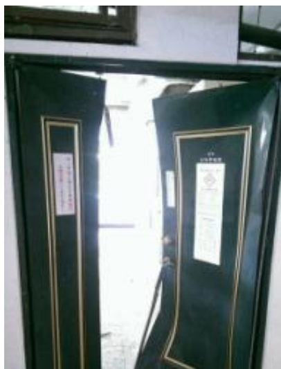
隔間門變型受損
